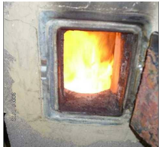
Russbrand in oberer Reinigungsöffnung erkennbar
